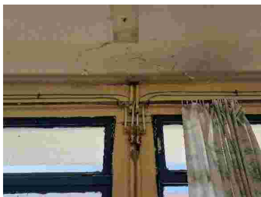
Εικ. 12 Τάξη 3 ου Ορόφου, τα εξαερίστηκά των καλοριφέρ αντικαταστάθηκαν αφήνοντας εμφανή κακοτεχνία.
