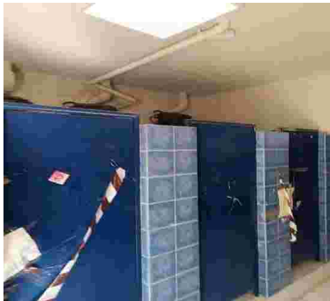
Εικ.1 Τουαλέτες εκτός λειτουργίας. Λόγο προδιαγραφών κατασκευής, η σύνδεση με τον οχετό αποβλήτων είναι απευθείας χωρίς σιφωνισμό, με αποτέλεσμα την δυσσομία και δυσκολία απόφραξης όπως πληροφορηθήκαμε από τα συνεργεία συντήρησης του δήμου.
