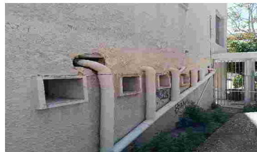
Εικ. 5 Εμφανείς κακοτεχνίες στη στήλη αποχέτευσης κατά την μεταγενέστερη παράκαμψη εξωτερίκευσης της αποχέτευσης.
