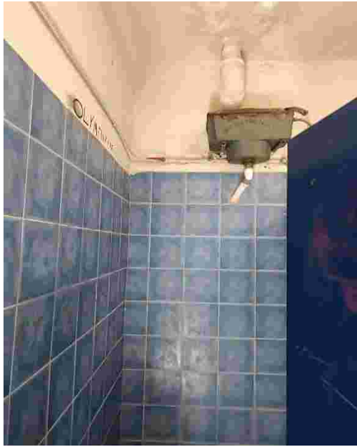
Εικ. 6 Ενδεικτικό δείγμα από τη διάβρωση που έχει εμφανιστεί ίσως από την πλημμυρή παράκαμψη της αποχέτευσης. Απαιτείται περαιτέρω έρευνα από αρμόδιο τεχνικό και στις υπερκείμενες τουαλέτες του 1 ου Ορόφου.
