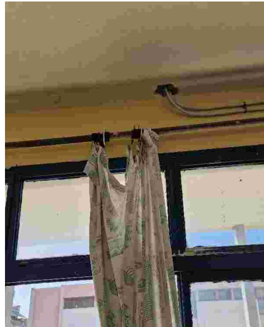
Εικ. 22 Σκουριασμένα κουρτινόξυλα με κουρτίνες που δεν παρέχουν καμία προστασία από τον ήλιο, ζέστη ή κρύο. Χρήζουν άμεσης αντικατάστασης από κουρτίνες με μόνωση, ειδικότερα όταν πρόκειται να εγκατασταθούν διαδραστικοί πίνακες που απαιτούν ελεγχόμενο φωτισμό.
