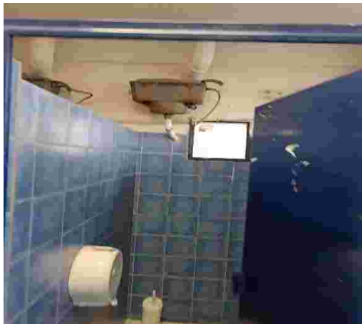
Εικ. 8. Όλες οι τουαλέτες του ισογείου (Ανδρικές) στερούνται παραθύρων καθότι έχουν αφαιρεθεί λόγω προχωρημένης διάβρωσης του σιδερένιου πλαισίου με αποτέλεσμα να κινδυνεύει η ιδιωτικότητα των μαθητών.
