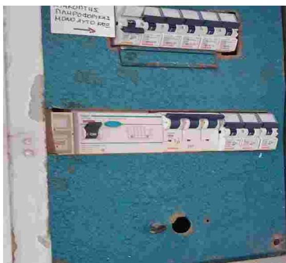
Εικ. 23 Ηλεκτρολογικός Πίνακας
