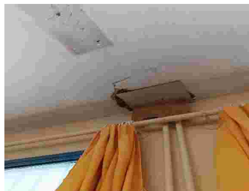
Εικ 13 Υποστυλωμένος Σοβάς οροφής σε τάξη 2ου ορόφου. Διάβρωση που ίσως προκλήθηκε από διαρροή στη σύστημα θέρμανσης.
