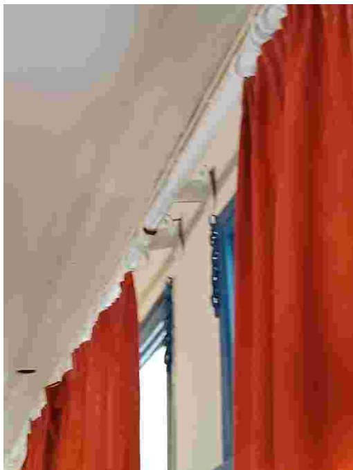
Εικ. 20 & 21 Τα κουρτινόξυλα, όπου υφίστανται καθώς τα περισσότερα έχουν αποκολληθεί τελείως, έχουν διαβρωθεί με αποτέλεσμα να μην ολισθαίνουν και οι κουρτίνες, όπου αυτές υπάρχουν να μην μπορούν να χρησιμοποιηθούν. Είναι βέβαιο ότι χρήζουν αντικατάστασης όχι μόνο οι κουρτίνες αλλά και τα κουρτινόξυλα
