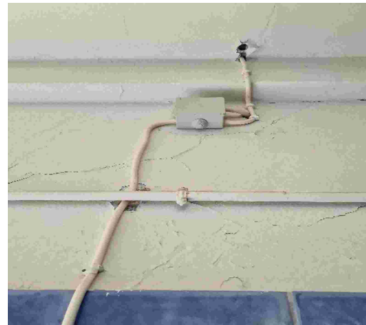
Εικ 9 Η πλημμυλής εκτέλεση έργων είναι εμφανέστατη με απροστάτευτα ηλεκτροφόρα καλώδια να είναι σε συνεχή επαφή με σωλήνες ύδρευσης. Οι τεχνικοί του δήμου μπορούν να επιβεβαιώσουν ότι η συγκεκριμένη εγκατάσταση δεν πληροί ούτε τις βασικές τεχνικές προδιαγραφές
